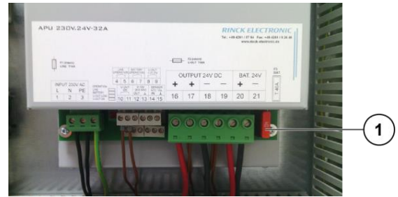
Abb. 10: APU mit Akkusicherung
