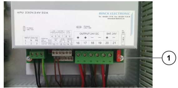
Abb. 10: APU mit Akkusicherung
