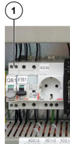
Abb. 9: Netzblock mit Hauptschalter QB1
