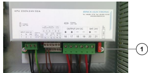
Abb. 10: APU mit Akkusicherung
